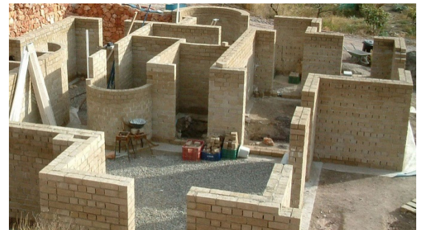
muros de Cannabric en construcción arquitecta: Dr a Monika Brümmer, España en 2005
